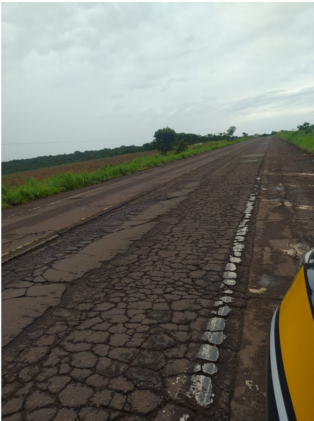
h) Km 185,6 Decrescente. Sem Sinalização vertical de proibido ultrapassar;
