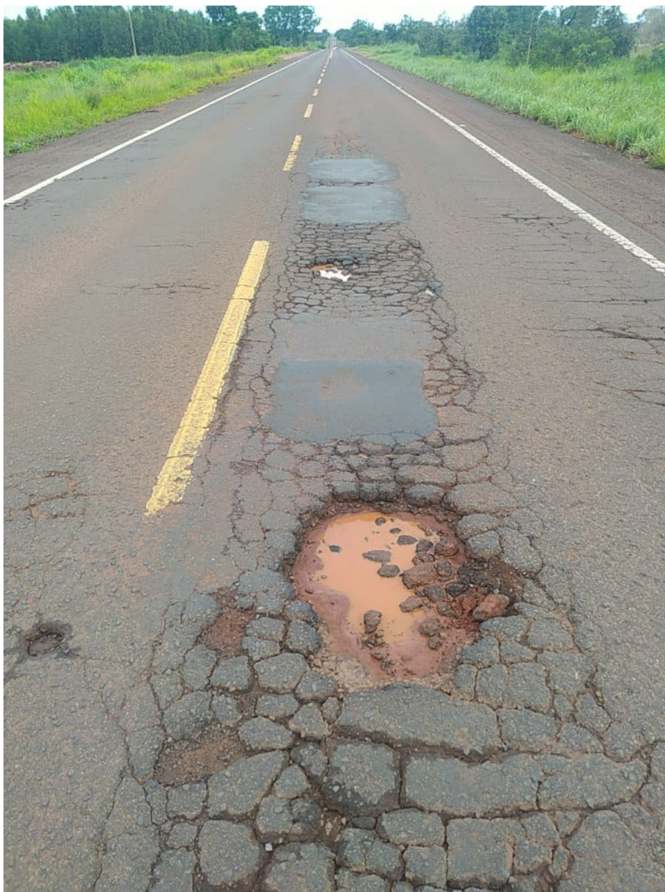
v) Km 153,8 até 155,2 C/D. Acostamento danificado;
