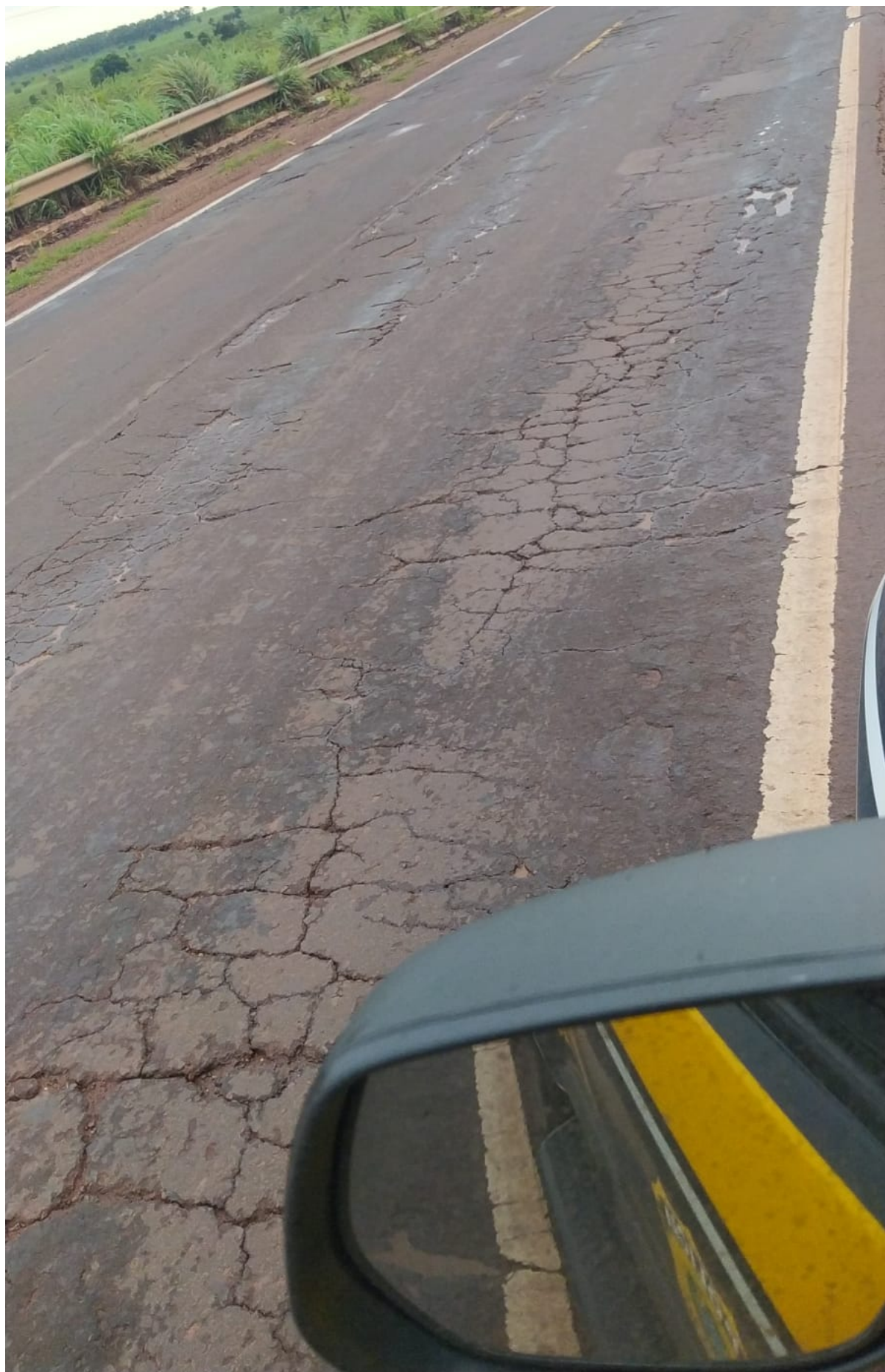
u) Buracos no km 163;
