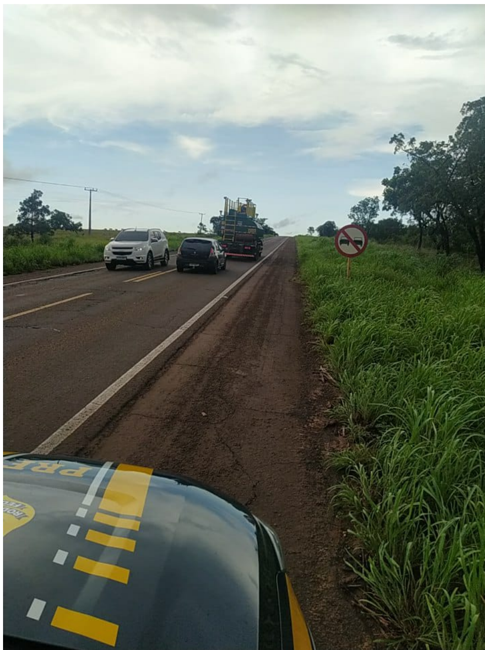
b) Km 164,9 Crescente. Sinalização danificada;
