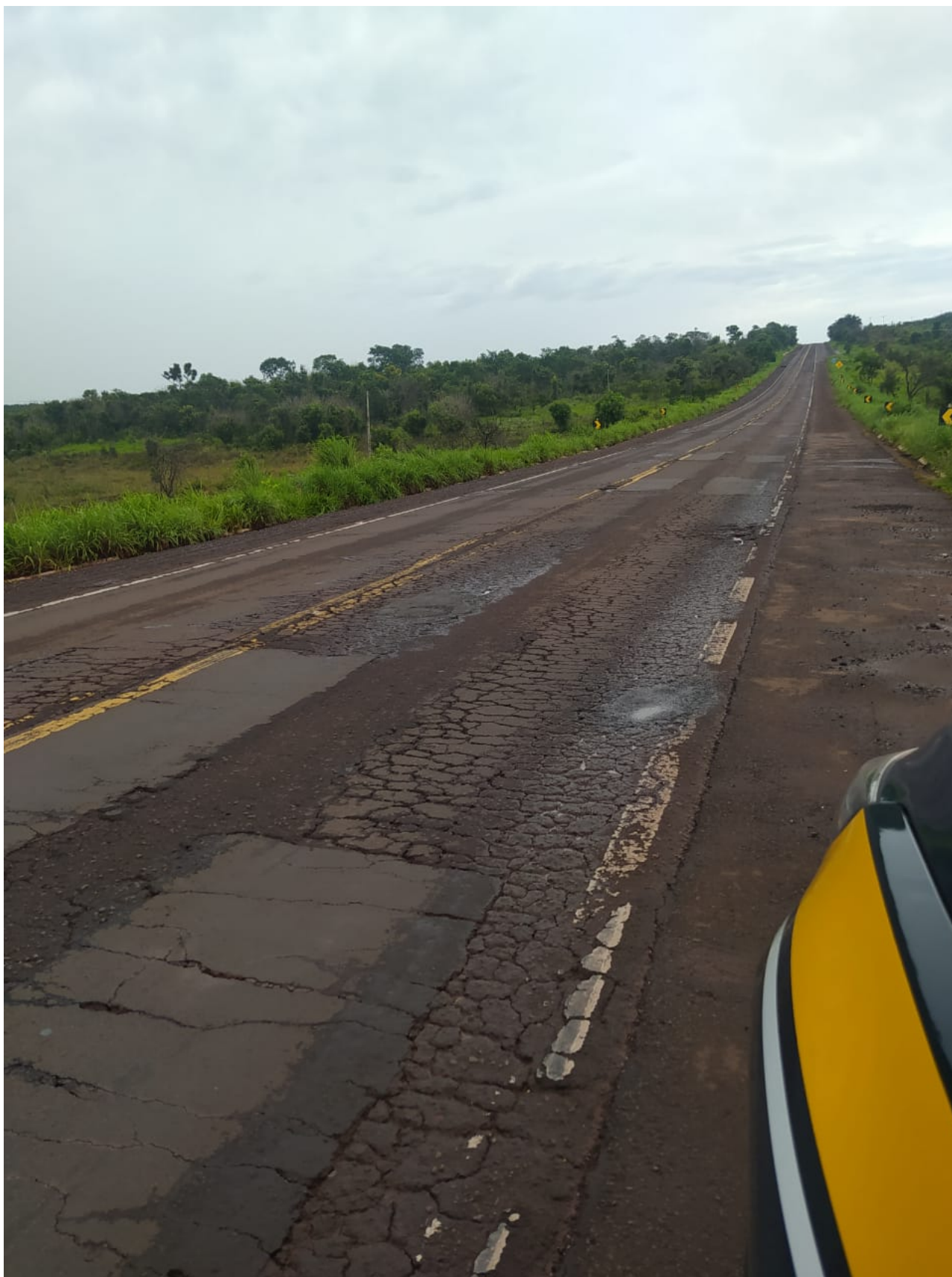
g) Km 181 inteiro com sinalização horizontal danificada, inclusive na curva;
